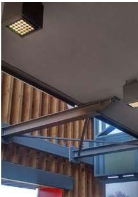
Area di Servizio - Villarboit (VC) - Italia
