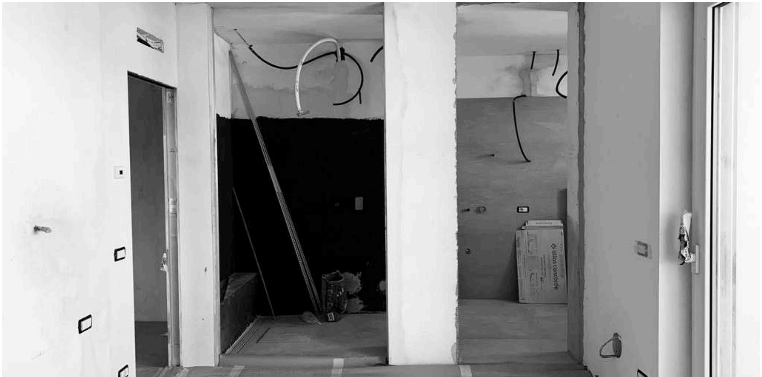
Casa D. - ristrutturazione di un attico a Modena - progetto di interioring - disimpegno camera da letto
