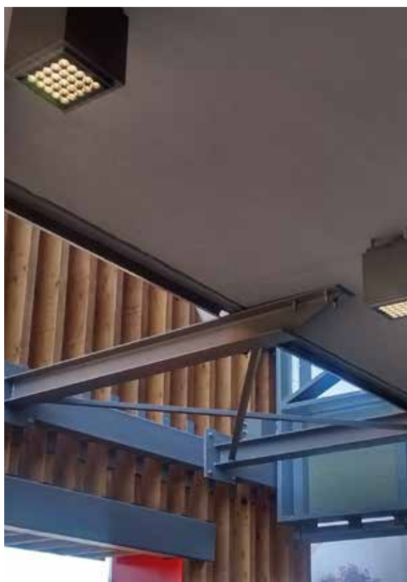
Area di Servizio - Villarboit (VC) - Italia
